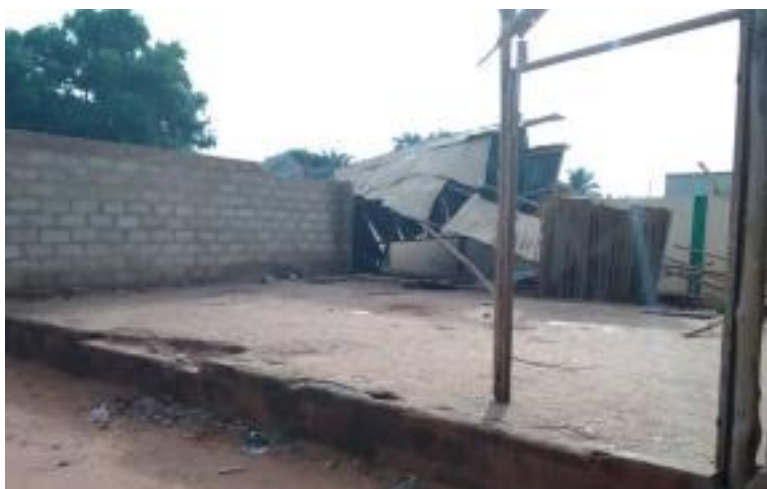
屋根は壁の向こう側まで吹き飛ばされました。
